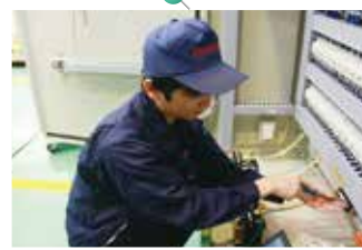
電圧のチェックなど配電盤が正常かどうか確認します
